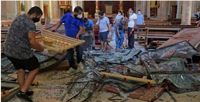
Aufräumarbeiten in einer von der Detonation beschädigten Kirche in Beirut.
